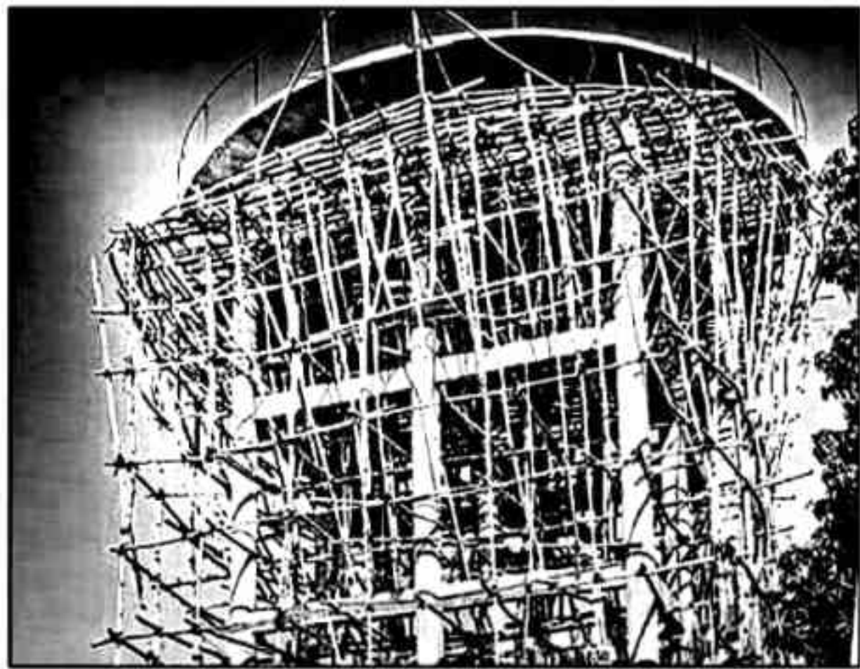
रसूलपुर दियरा में बंद पड़ा पानी टंकी का निर्माण
